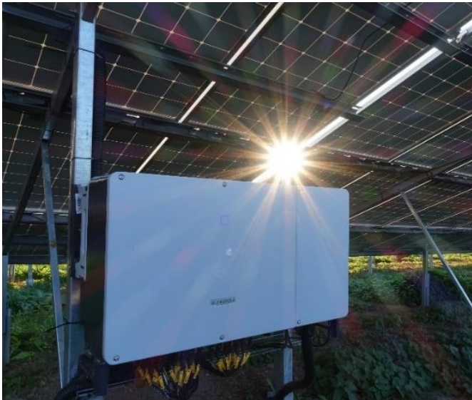
Herzstück: Wechselrichter im Schatten der Module
