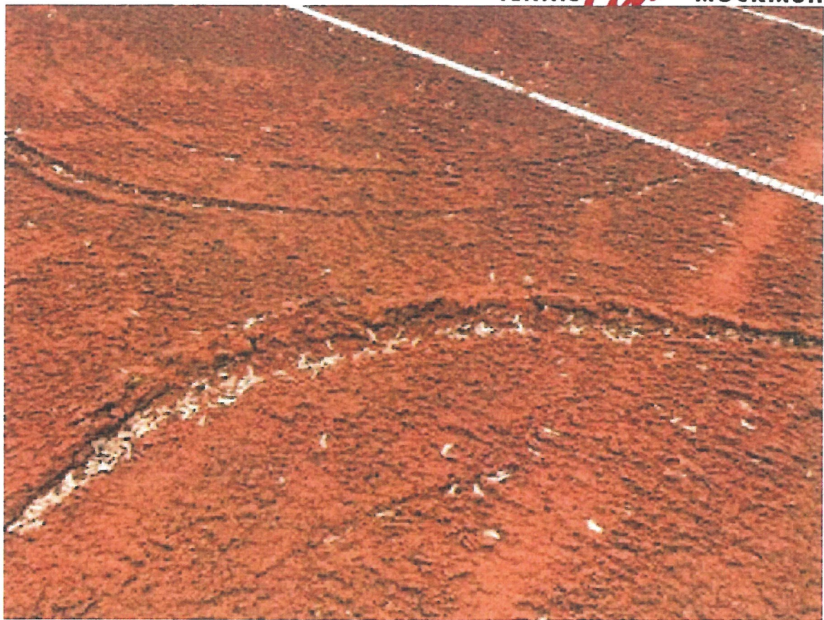
stark zerstörter Platz 3 und 4 (3)
